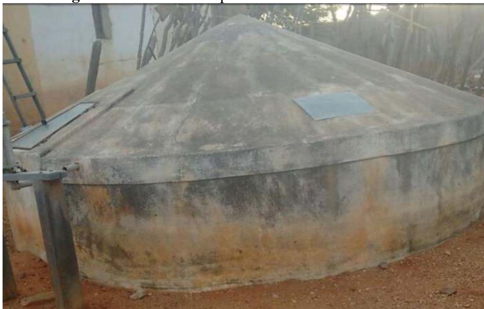
Figura 07 – Cisterna de placas – Zona rural de Pilões/RN
